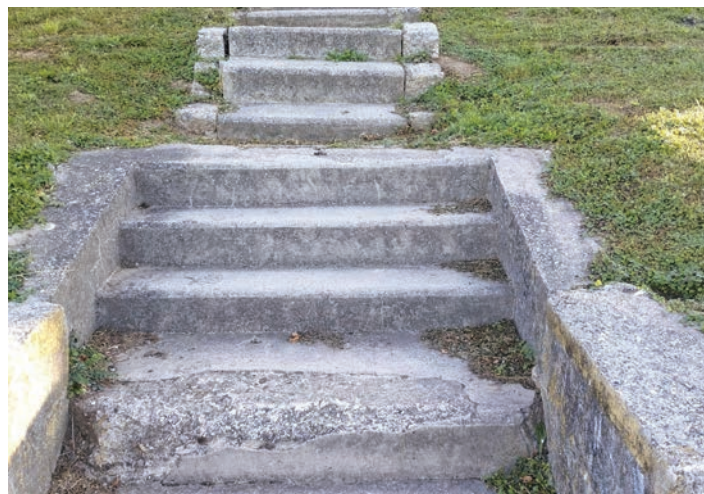
Staré terénní schody jsou v havarijním stavu.
